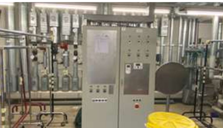
Heizungsraum des Ökumenischen Zentrum
